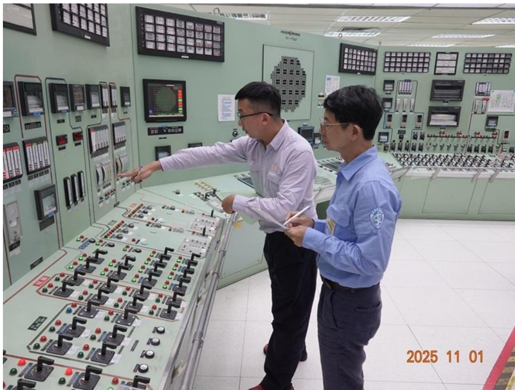
核安會視察員於 2 號機主控制室查核值班人員掌握機組狀況
