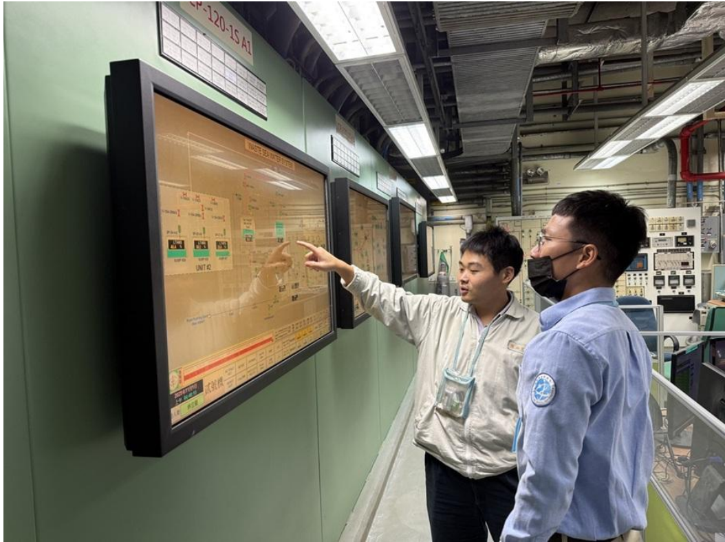
核安會視察員查核廢料控制室狀況
