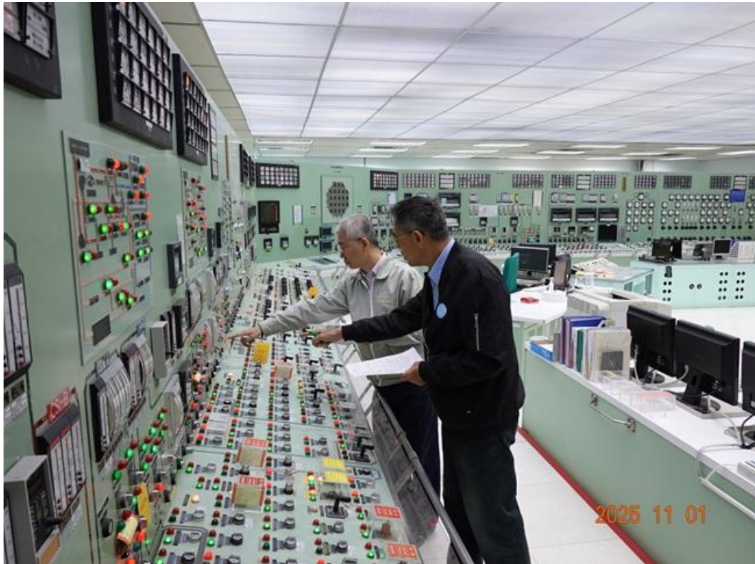
核安會視察員於 1 號機主控制室查核值班人員掌握機組狀況
