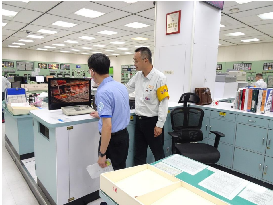
核安會廖科長於主控制室詢問機組狀況
