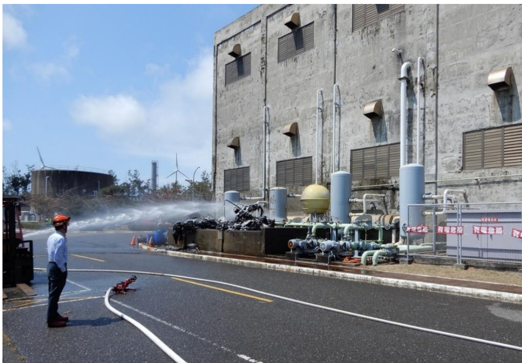
附件 2 3月6日冷卻水塔火災後之照片
