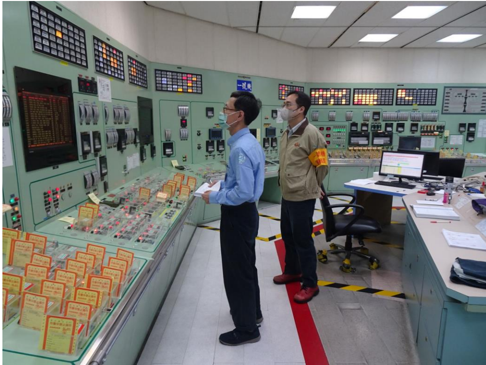
核安會視察員查核 1 號機控制室狀況
