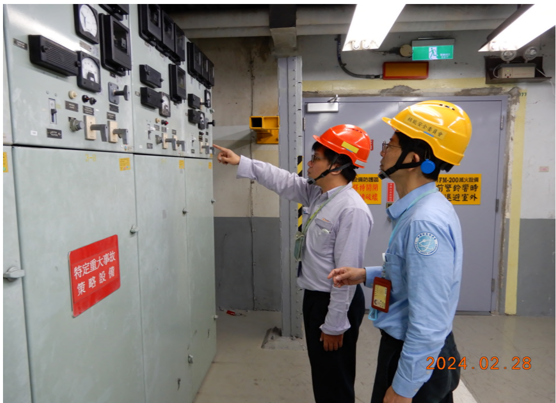
核安會視察員查核 2 號機聯合廠房現場設備狀況
