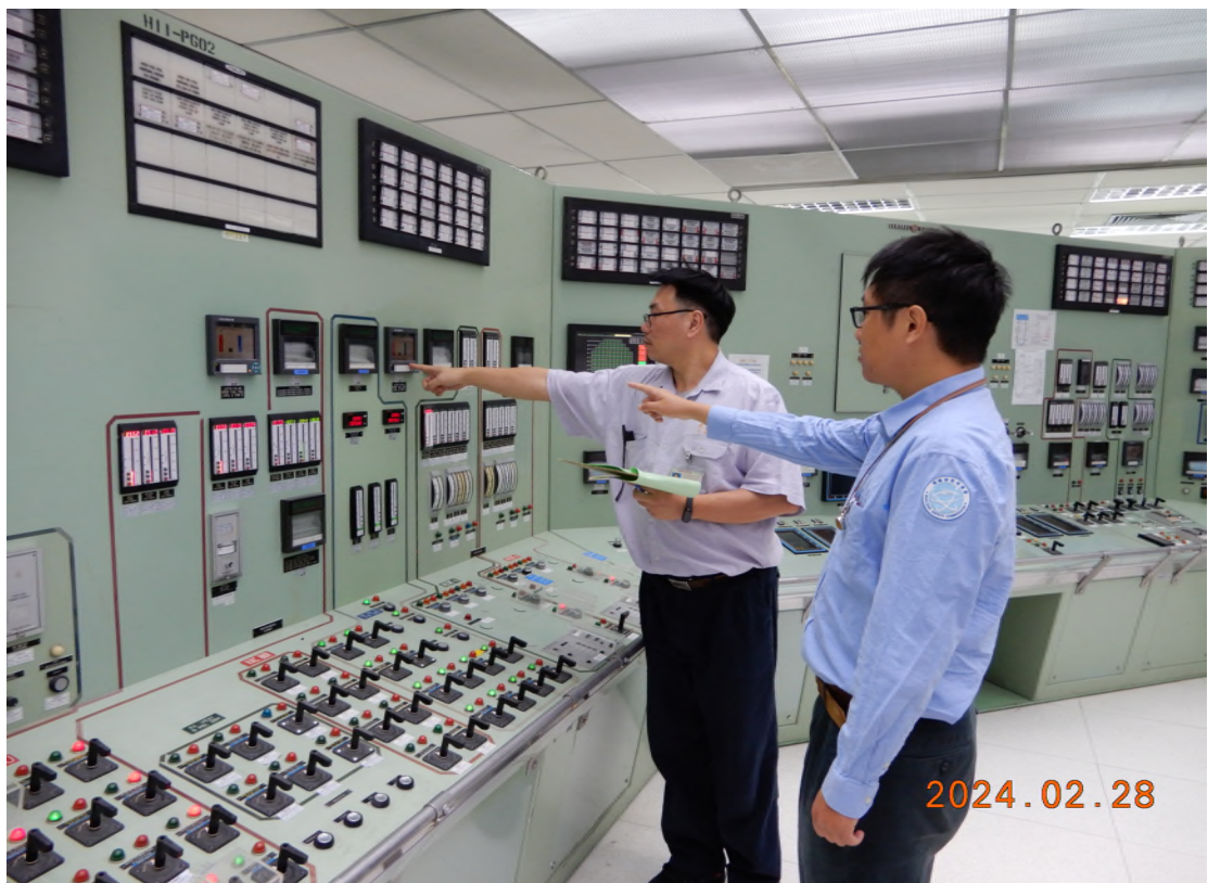
核安會視察員於 2 號機主控制室查核運轉值班人員機組掌握狀況
