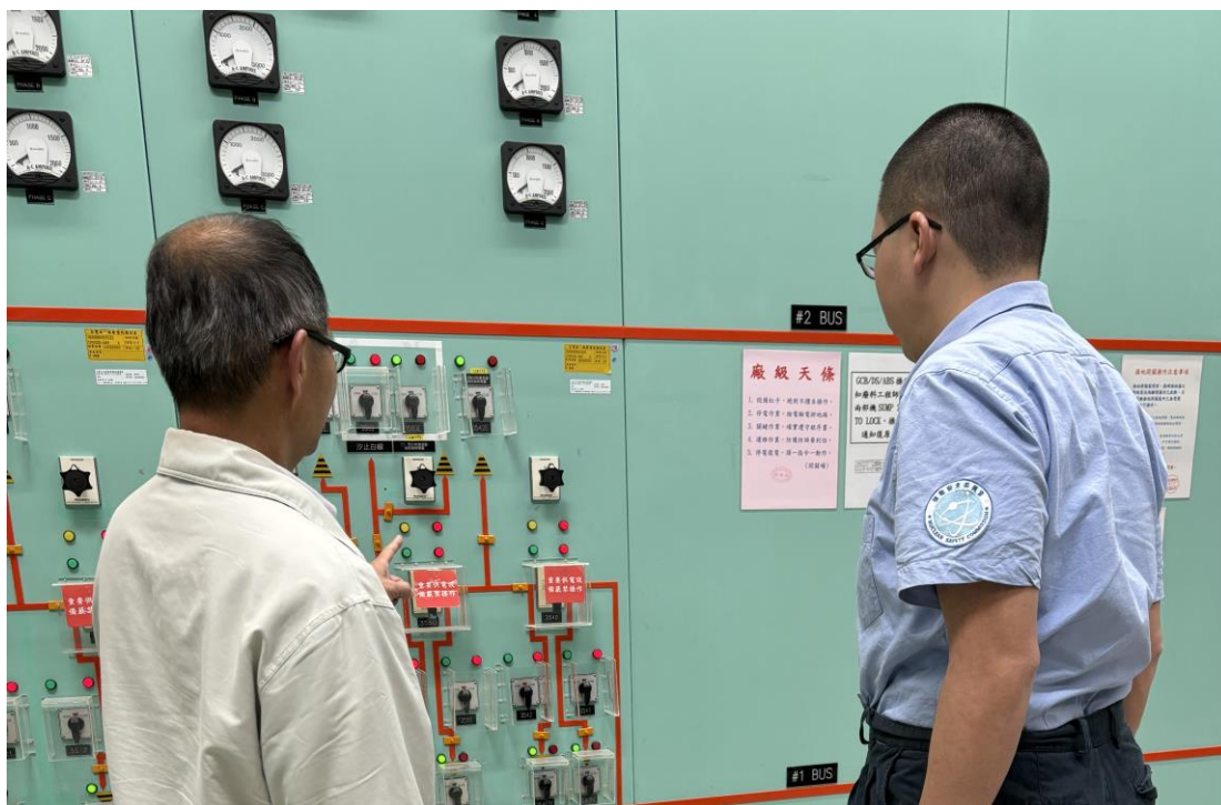
核安會視察員查核開關場控制室運作狀況
