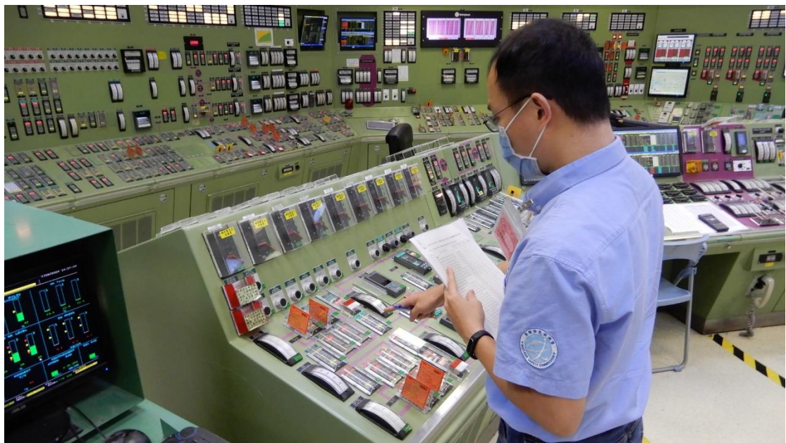
主控制室系統標示轉換作業
