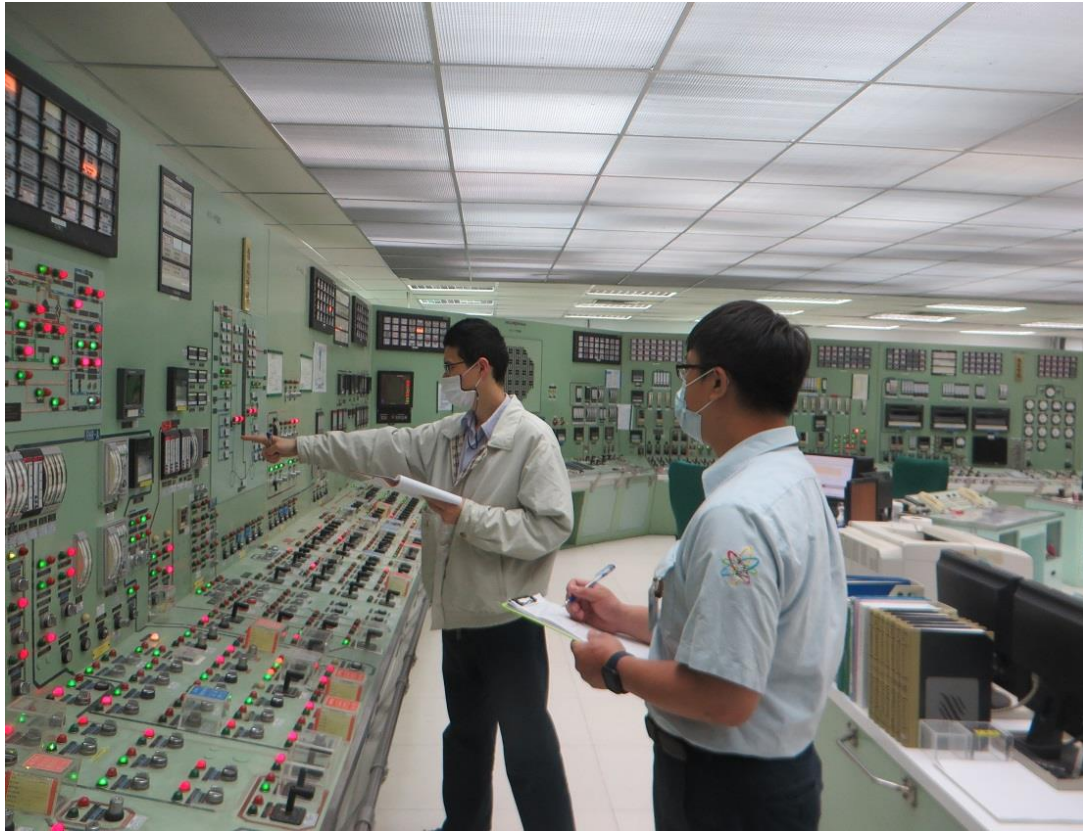
原能會視察員於 1 號機主控制室查核值班人員掌握機組狀況
