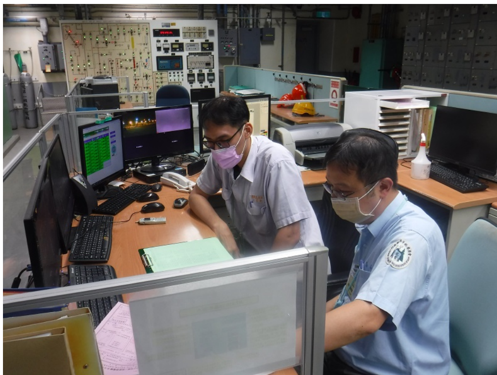
原能會視察員查核廢料控制室狀況
