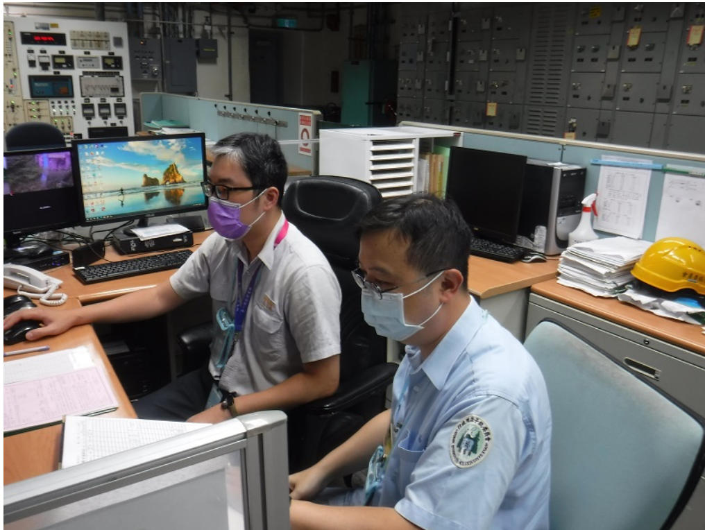
原能會視察員查核廢料控制室狀況
