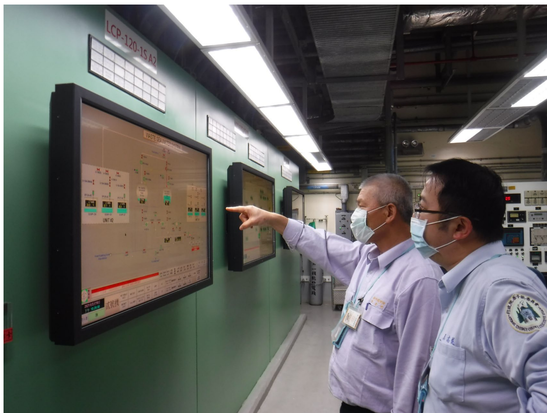
原能會視察員查核廢料控制室狀況
