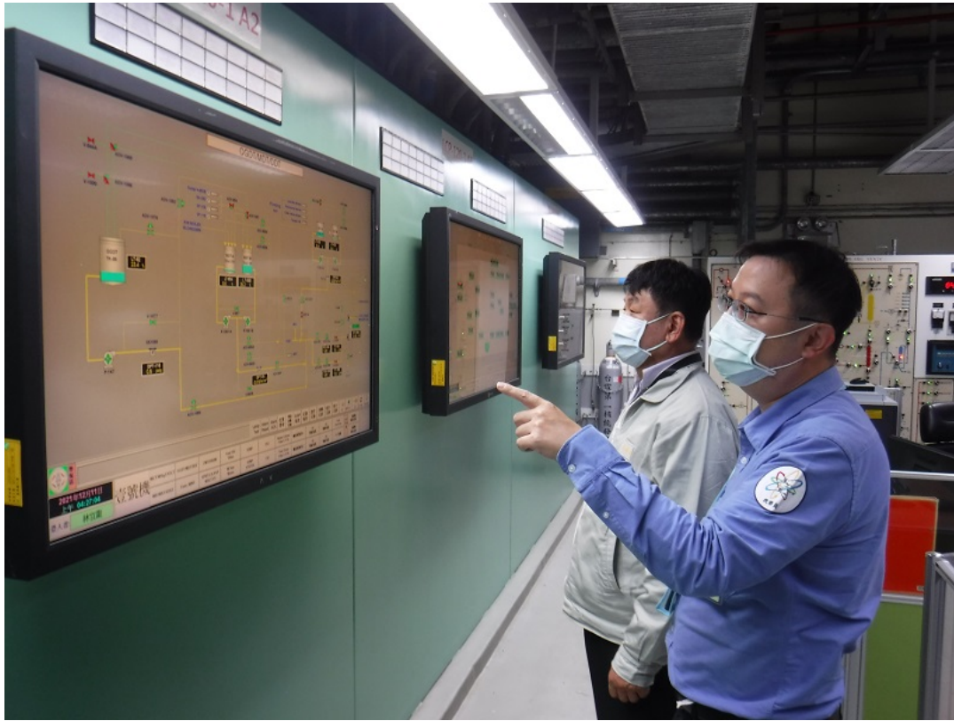
原能會視察員查核廢料控制室狀況
