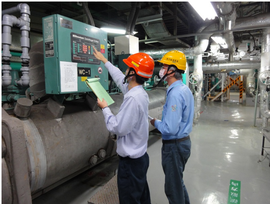
原能會視察員查核 2 號機聯合廠房現場設備狀況
