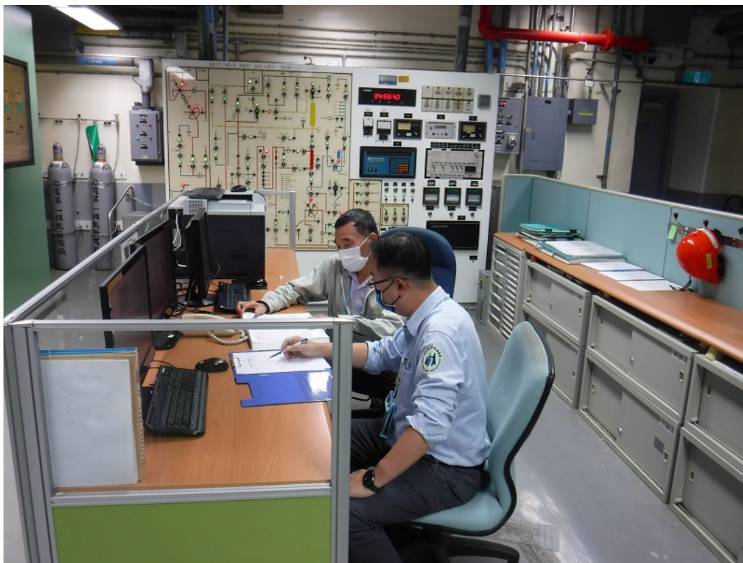
原能會視察員查核廢料控制室狀況
