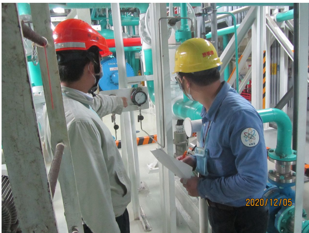
本會視察員於 1 號機現場查核值班人員機組掌握狀況
