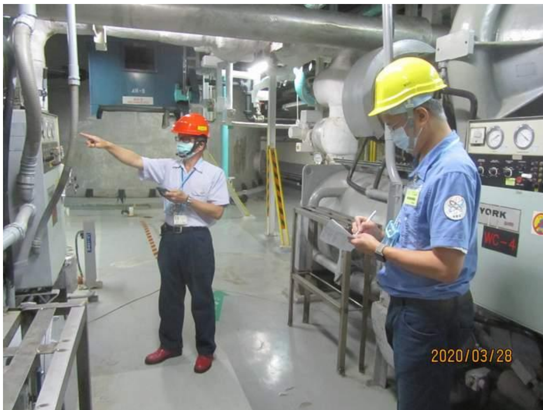
本會視察員於 2 號機現場查核值班人員機組掌握狀況
