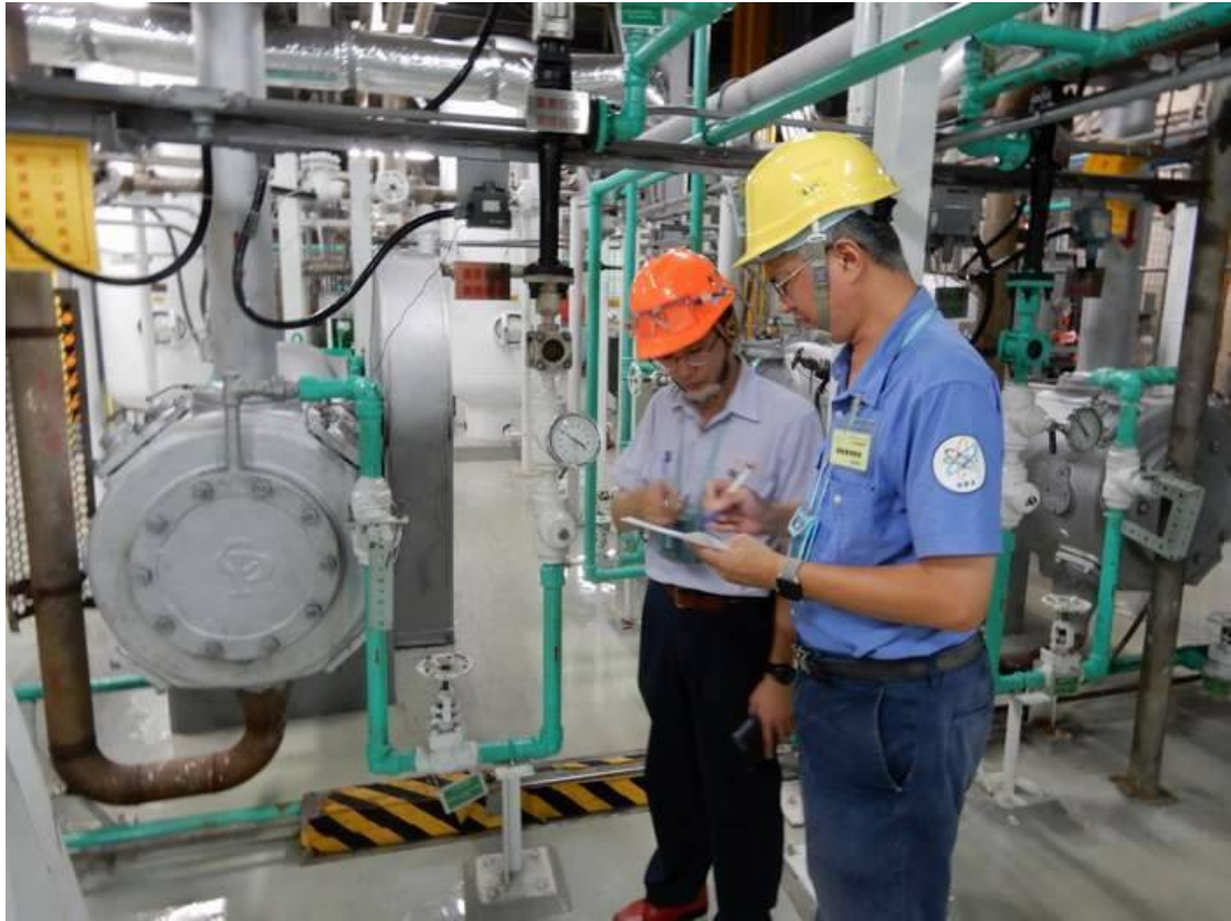
本會視察員於 1 號機汽機廠房查核值班人員現場巡視
