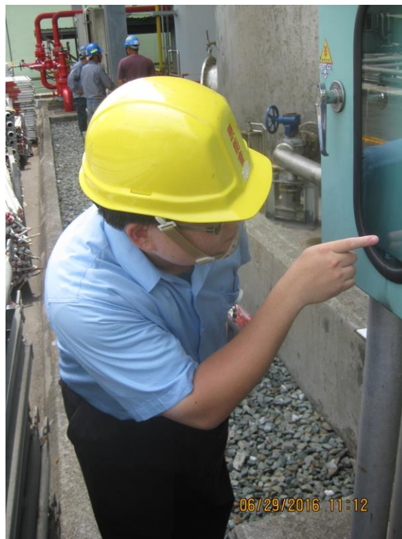
照片 2：沉水泵控制盤查證
