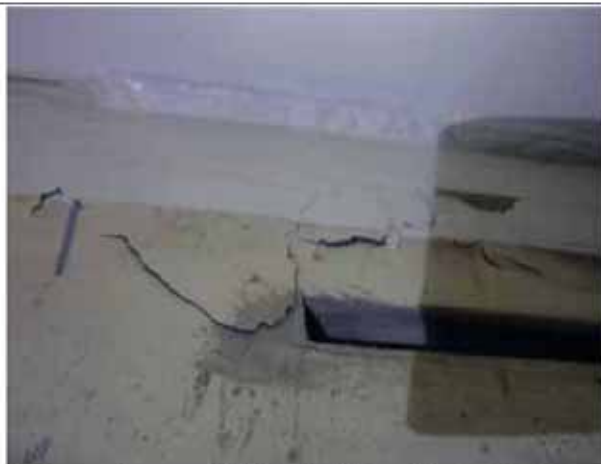
編號 129 之 Div III 儀器架室內之西南角牆面混凝土破裂結構損害情形
