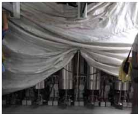
防塵套未完全遮蓋且有破損情形
