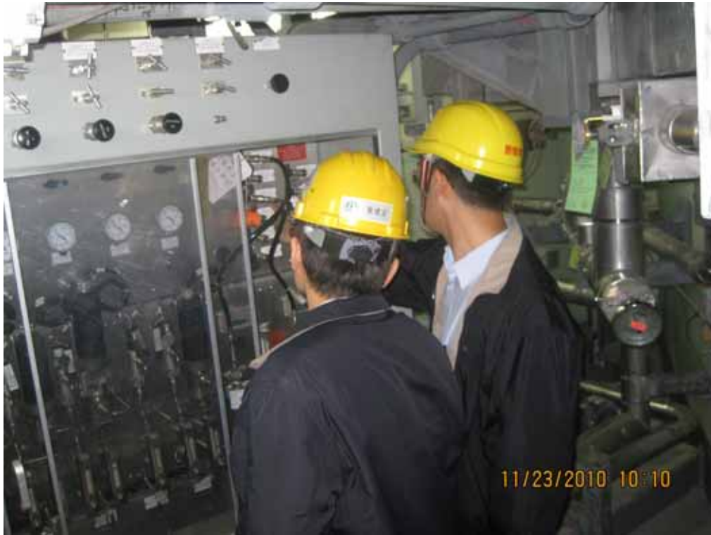
本會視察員於現場詢問龍門電廠現場取樣設備裝置情形
