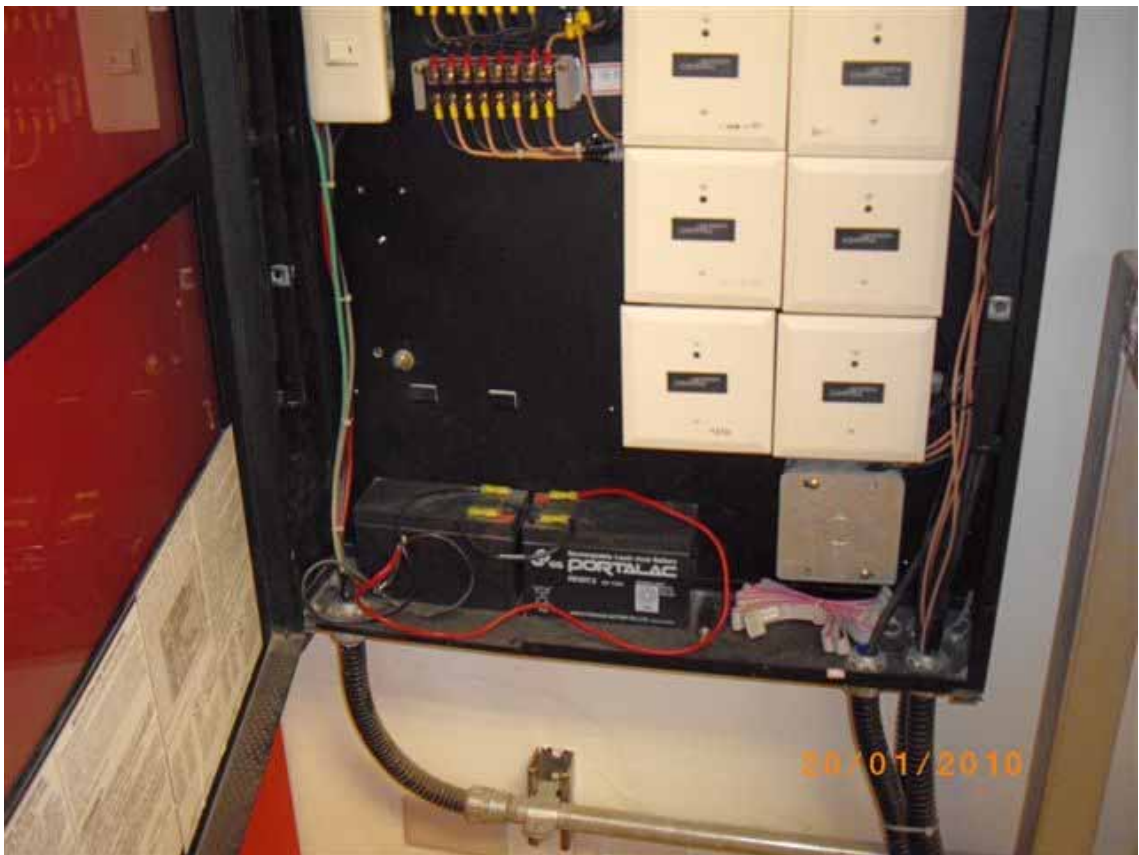
照片 4 開關場火災受信機現況
