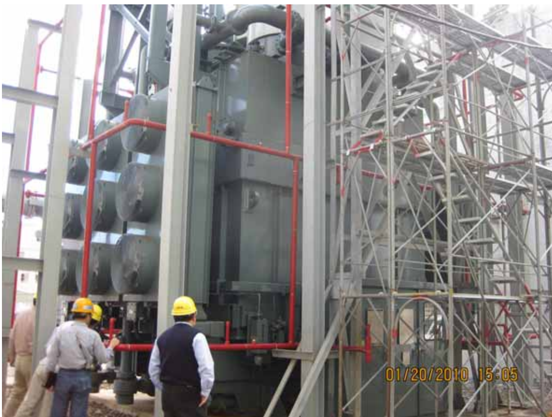
照片 6 變壓器消防管路查證
