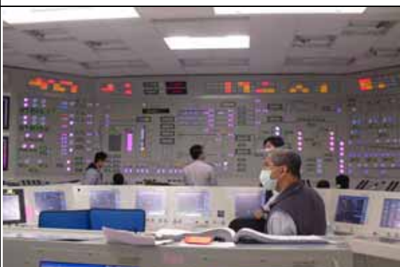
照片 4：龍門核電廠主控制室（一）
