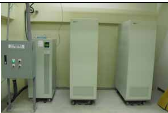
照片 6：模擬器 UPS 及隔離開關箱
