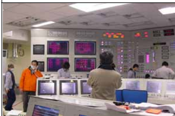
照片 5：龍門核電廠主控制室（二）
