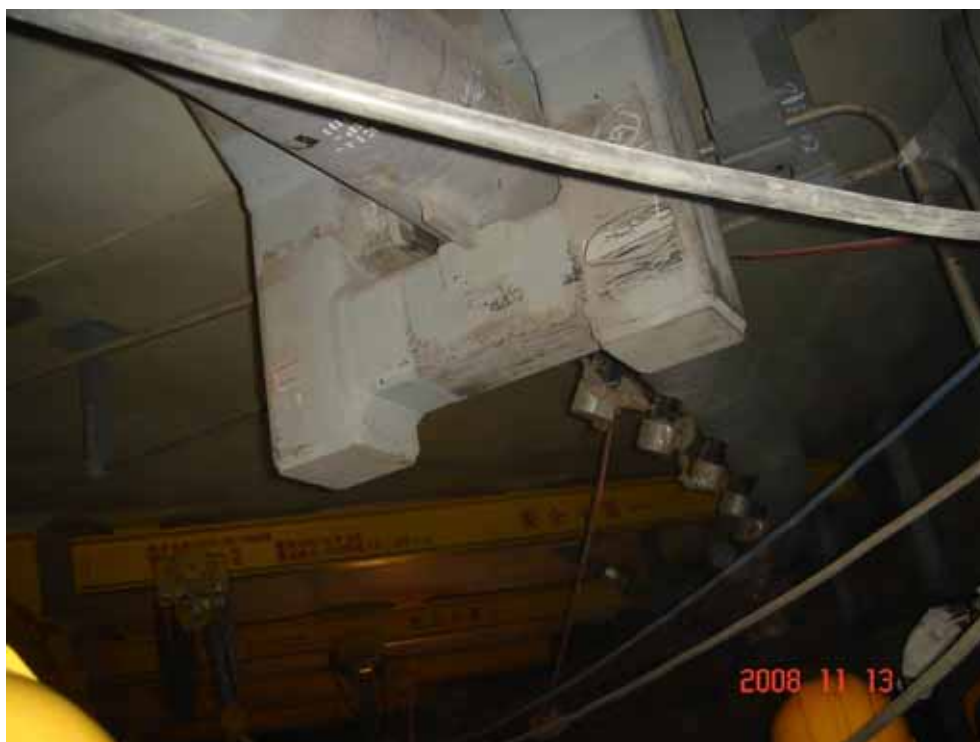
不銹鋼管與碳鋼支架直接接觸
