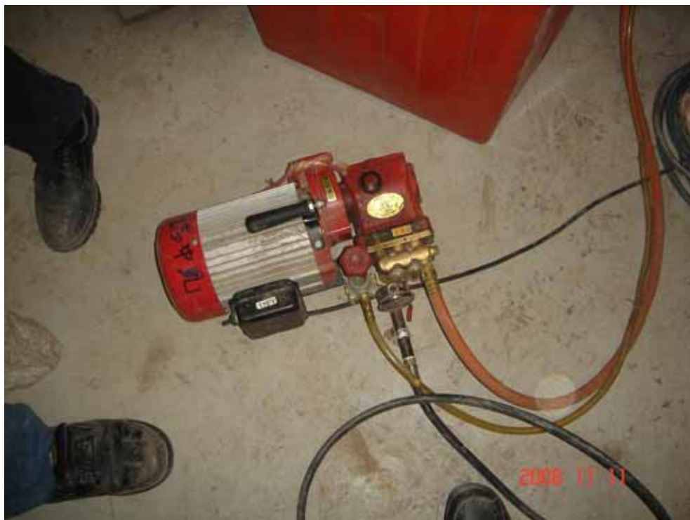
使用於 HPCF 管路水壓測試的加壓泵
