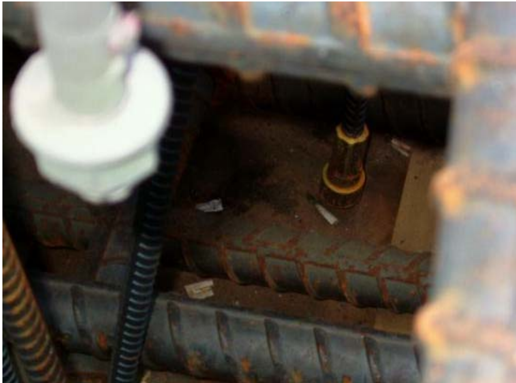
圖 9：二號機 D/F 樓版雜物未清情形
