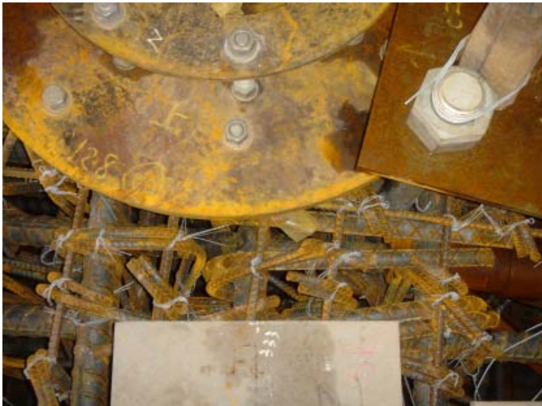
圖六：一號機隔膜地板箍筋排紮不正確情形
