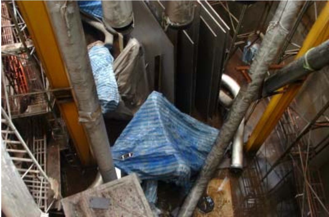
照片三、Quencher 已利用塑膠帆布覆蓋，設備保養維護已有改善
