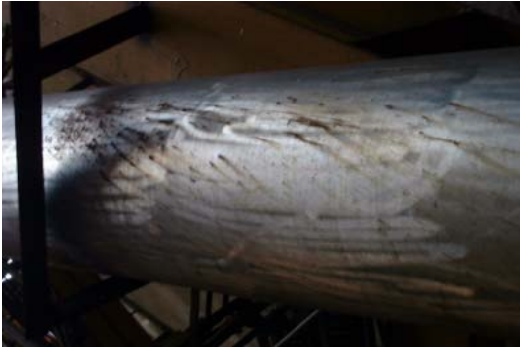
照片一、現場部分 SRVDL 不銹鋼管路上存有銲渣痕跡
