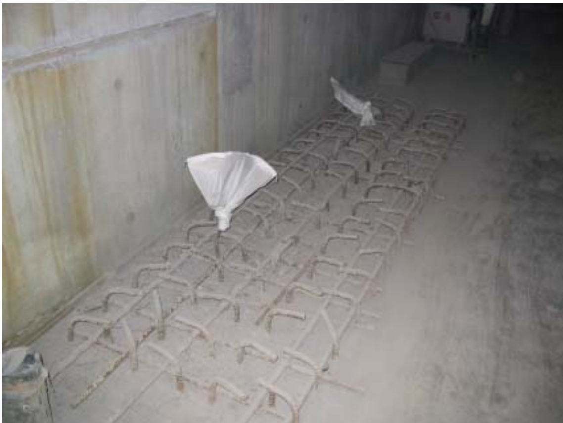
照片二：一號機反應廠房 EL-1700 之預埋接地線
