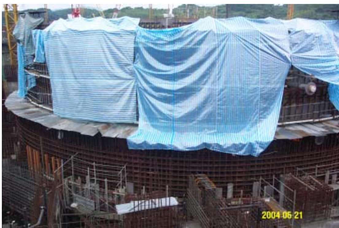
圖二：遮雨棚及帆布架設防護情形
