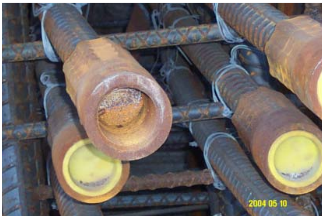
圖三：萬向接頭帽蓋脫落情形
