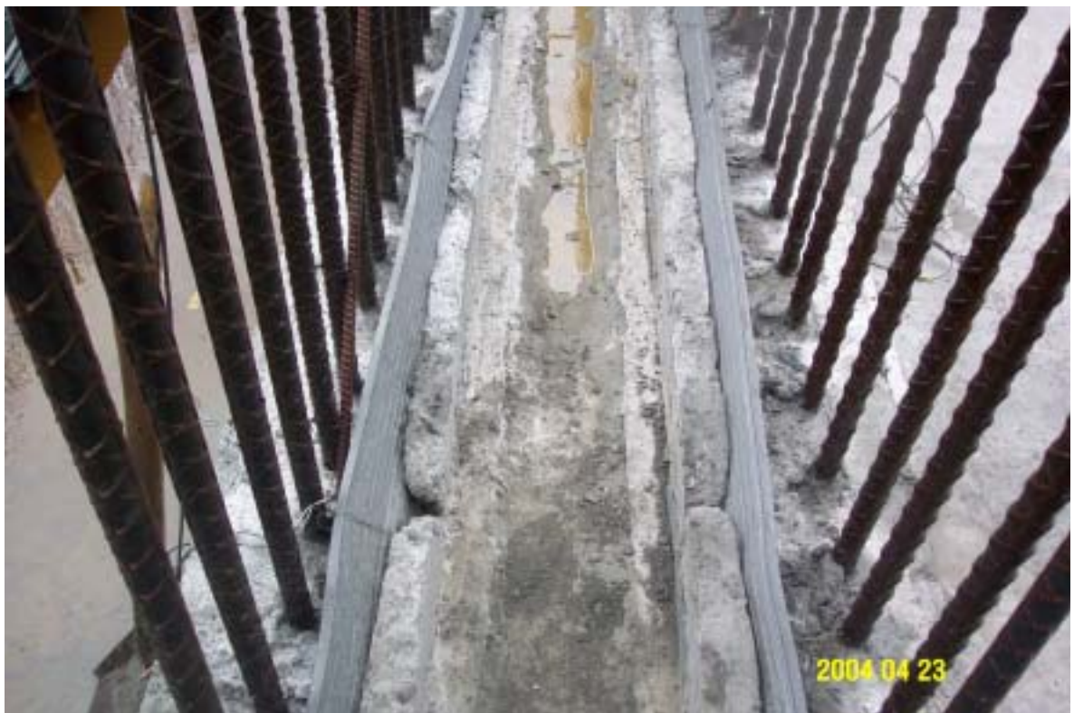
圖八：CWPB 外牆兩道止水帶混凝土圍束厚度不足情形
