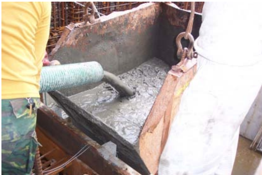
圖六：潤管用水泥砂漿洩入廢料槽內
