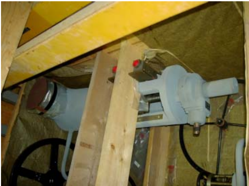
手動閥 1E22-BV-006B 儲存現況
