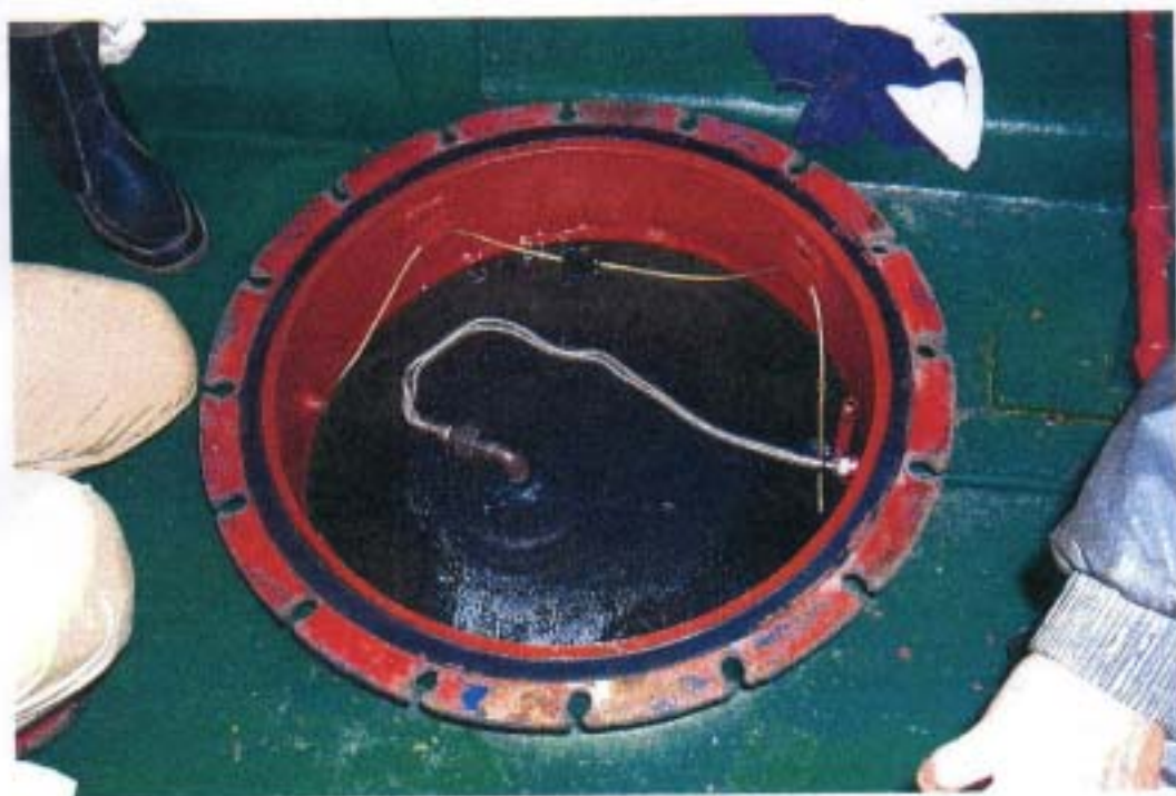
【主變壓器南側膨脹槽空氣袋正常膨脹狀】
