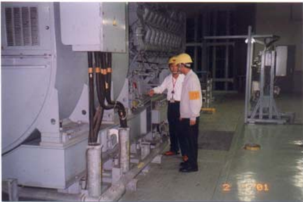
圖九 核一廠第五台柴油發電機
