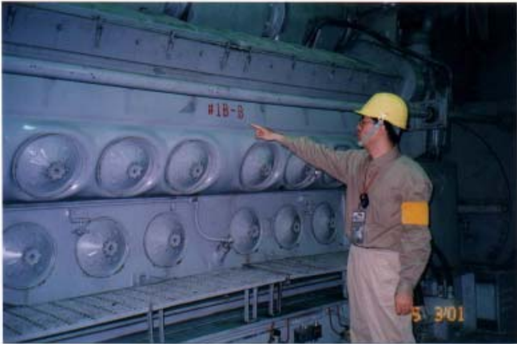
圖八 核一廠一號機柴油發電機 1B
