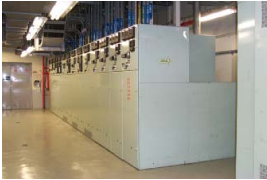
圖三 核一 廠一號機4.16KV 匯流排開關箱
