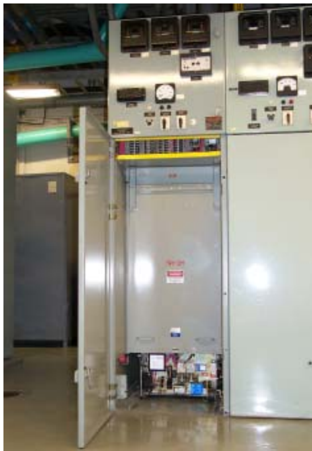
圖四 核一 廠4.16KV 斷路器搖入開關箱內
