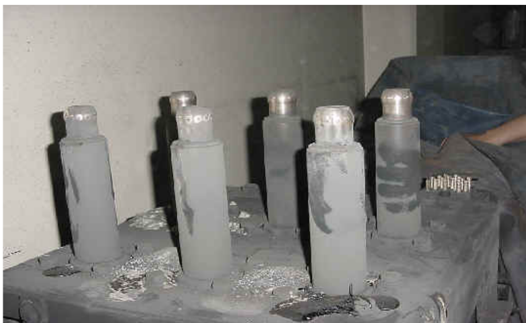
15號斷路器插入匯流排之連接頭損壞情形
