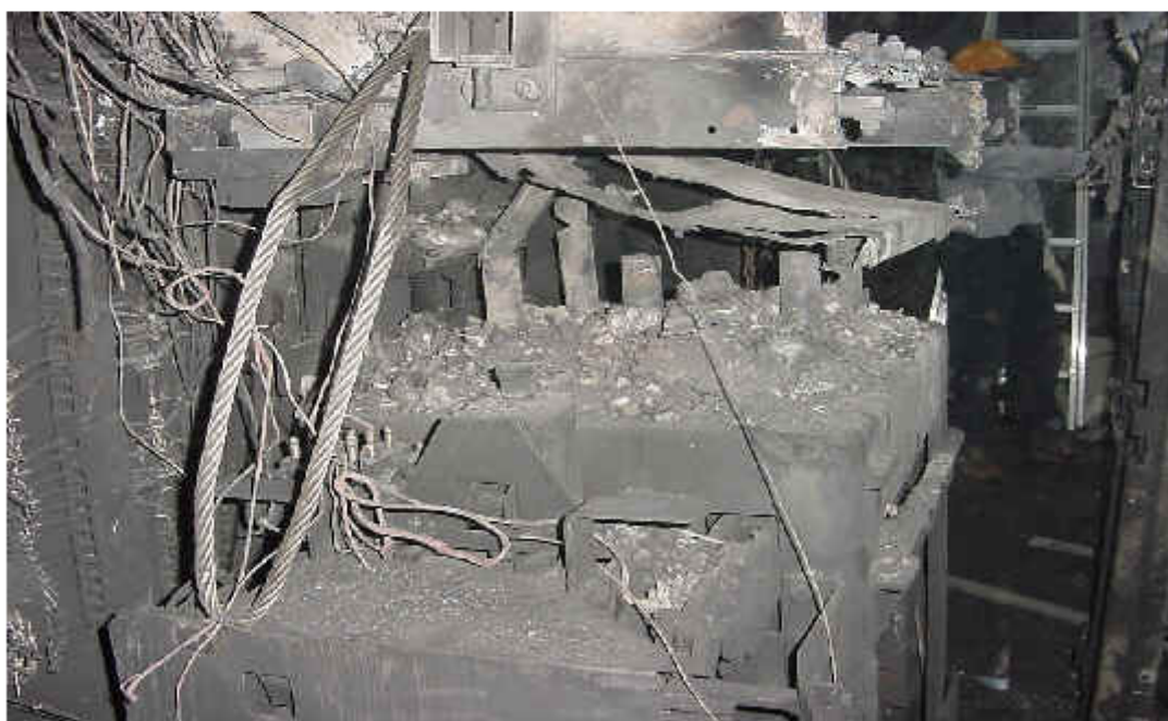
17號斷路器損壞情形
