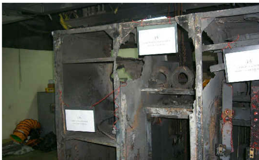
匯流排盤面損壞情形
