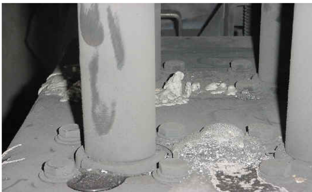
15號斷路器匡架損壞情形
