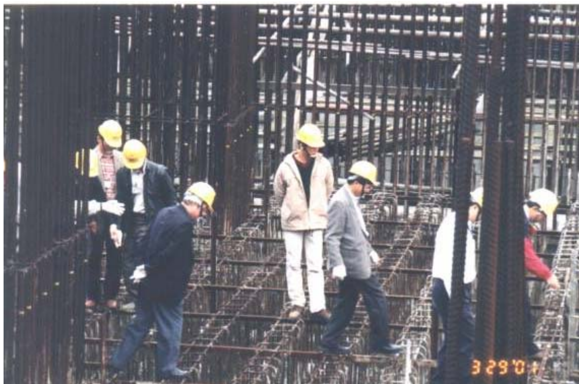
(圖五) 原能會會同專家學者赴汽機廠房現場實勘鋼筋鏽蝕情形
