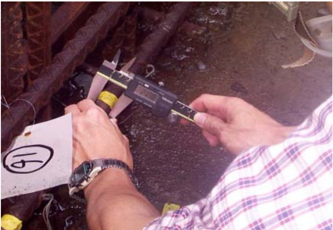
(圖十) 反應器廠房第二次進行每月一次外露鋼筋直徑量測以追蹤鋼筋腐蝕速率現況圖
