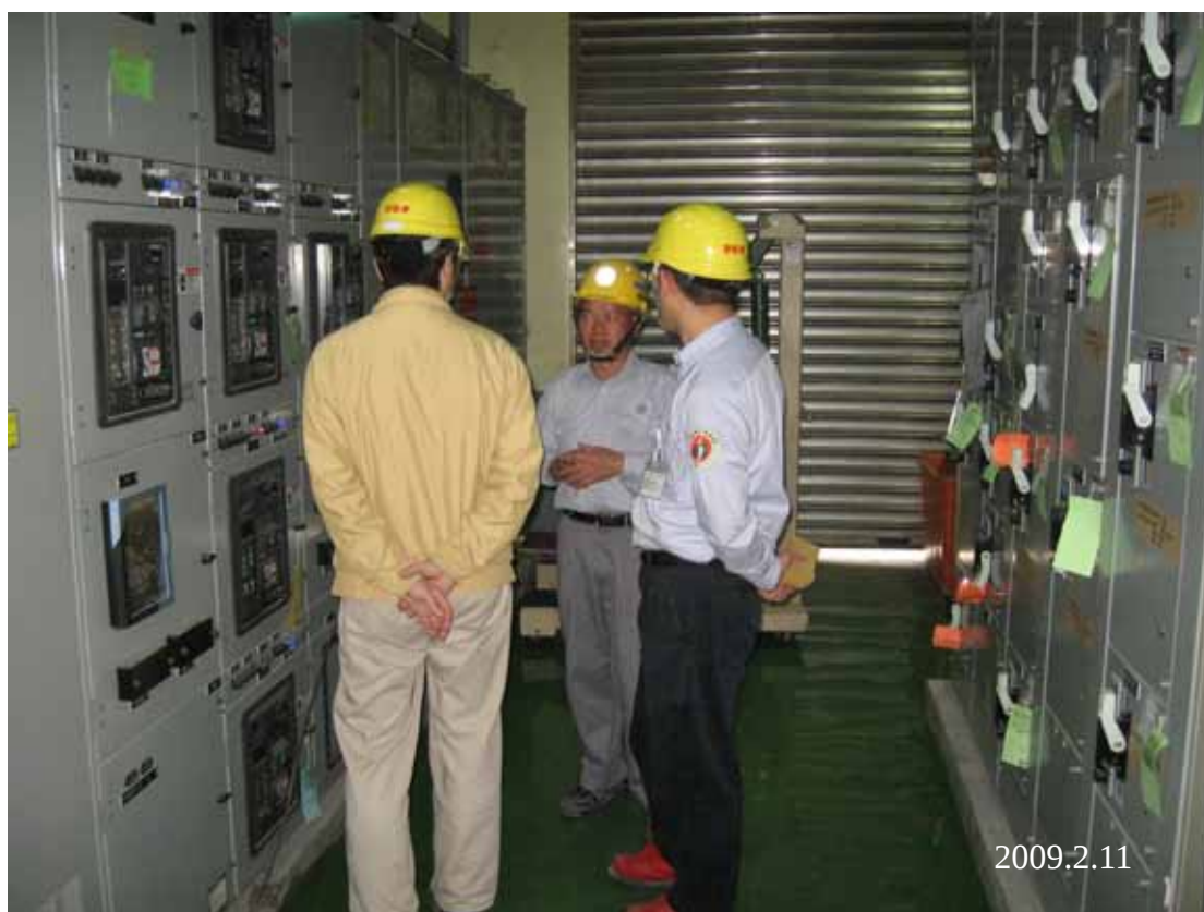
核四廠水廠電力開關箱現場視察
