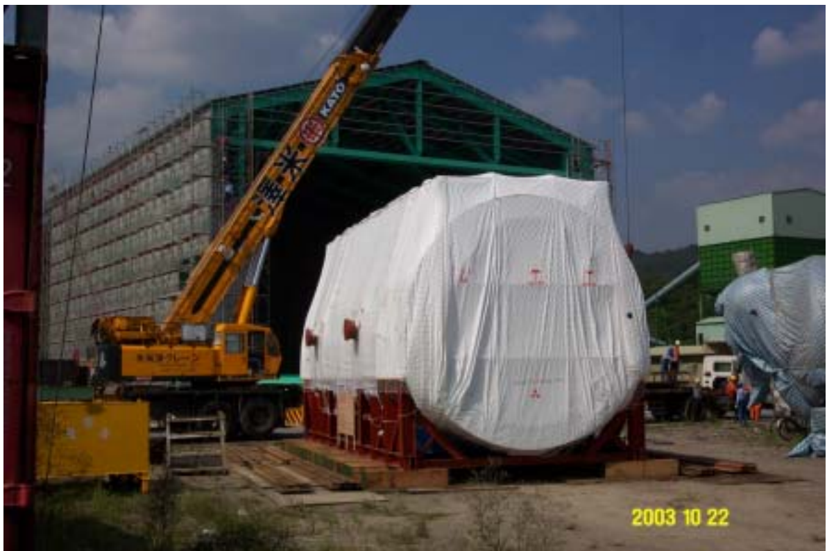
照片四：核四廠二號機汽機定子重件進廠儲存現況
