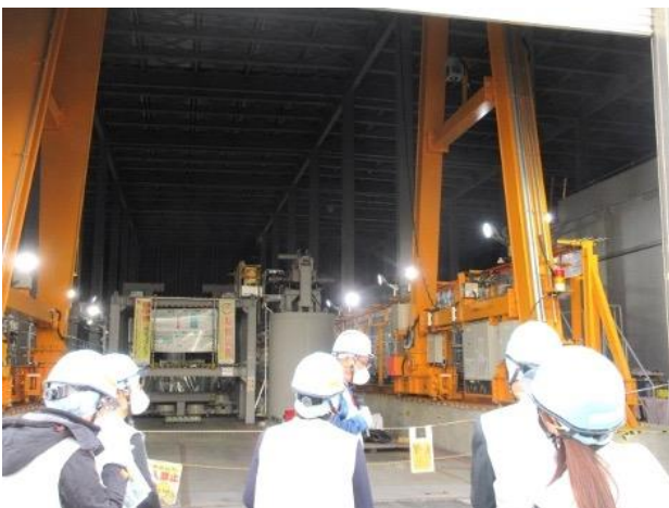
圖 12、「增設 ALPS」設備廠房
