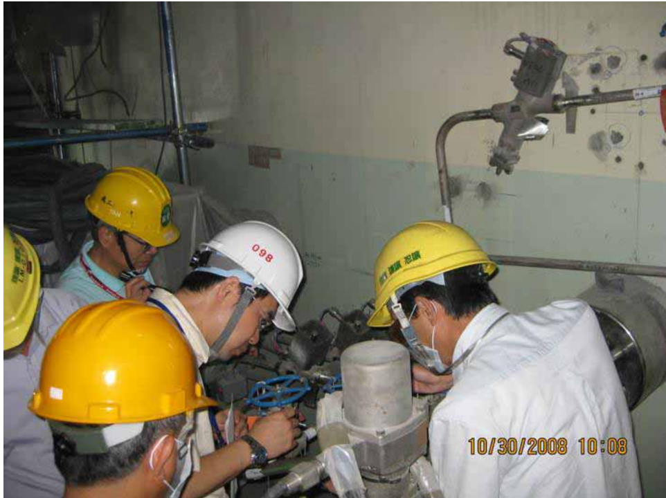
本會視察員針對反應爐水壓測試範圍鉸道現場查漏作業進行確認
