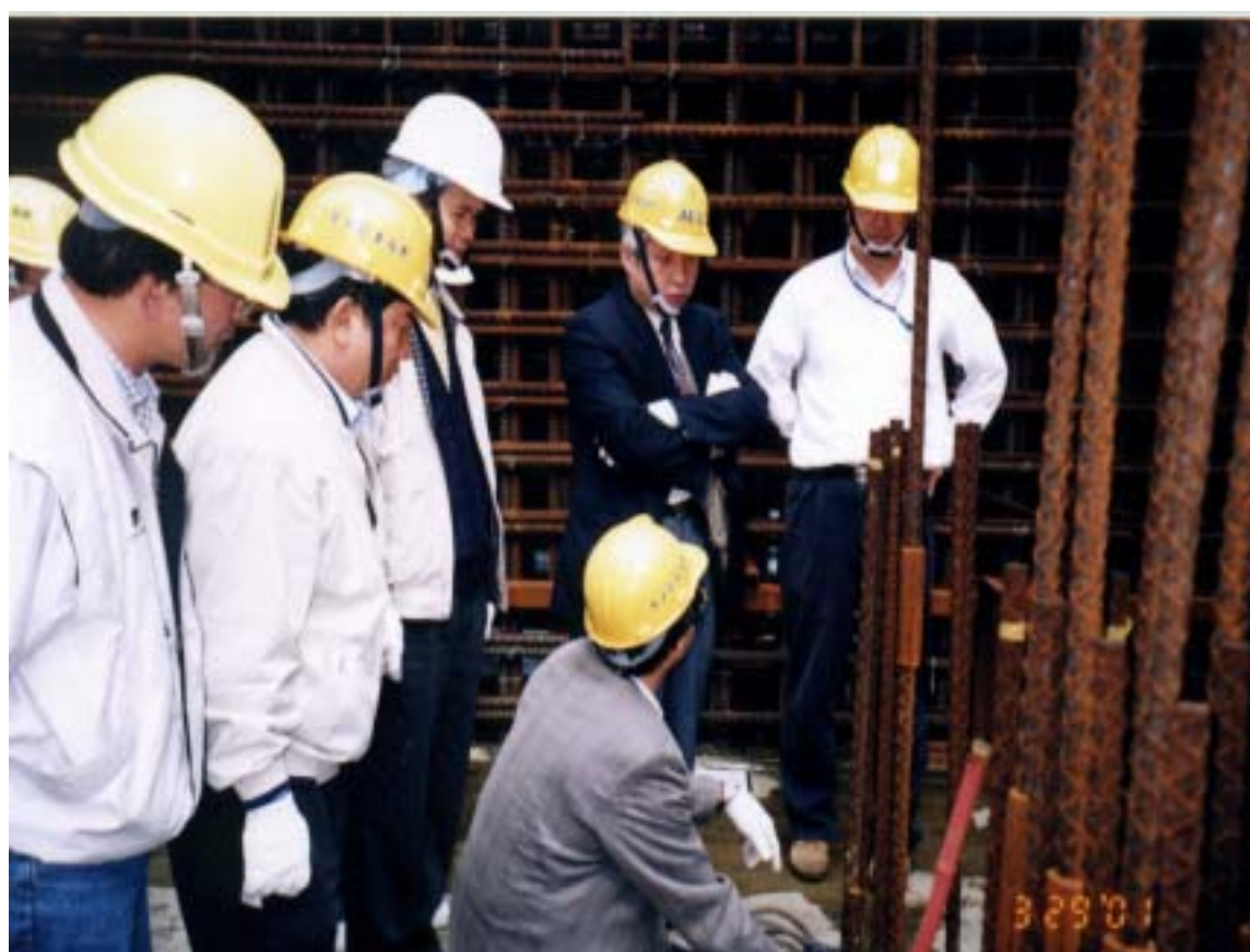
(圖十) 原能會會同專家學者赴反應器廠房現場實勘鋼筋鏽蝕情形
