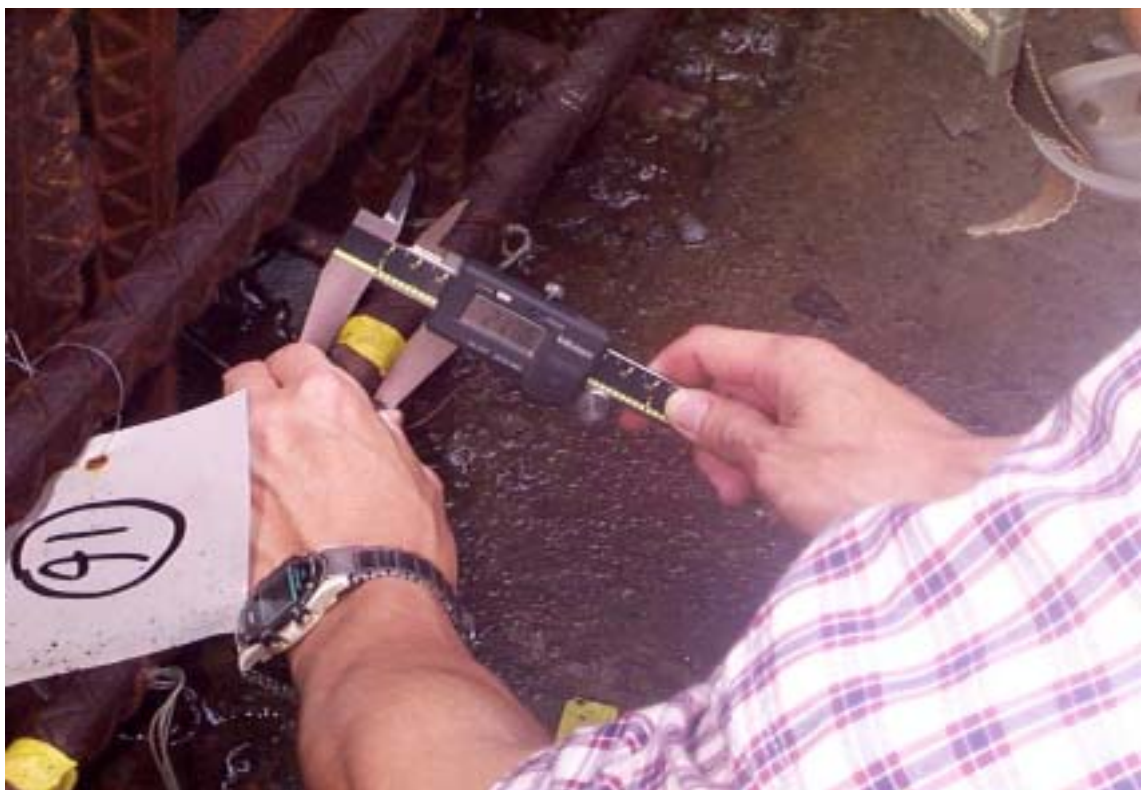
(圖十四)反應器廠房進行每月一次外露鋼筋直徑量測以 追蹤鋼筋鏽蝕速率情形
