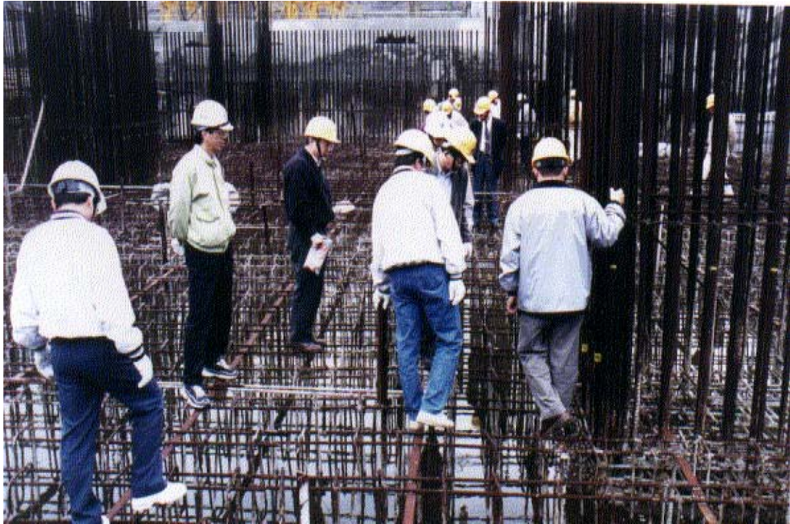
(圖十一) 原能會會同專家學者赴汽機廠房現場實勘鋼筋鏽蝕情形
