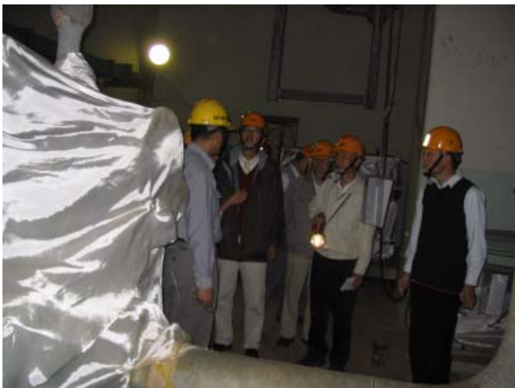
照片九：視察巡視一號機 RCIC 設備現場情形
