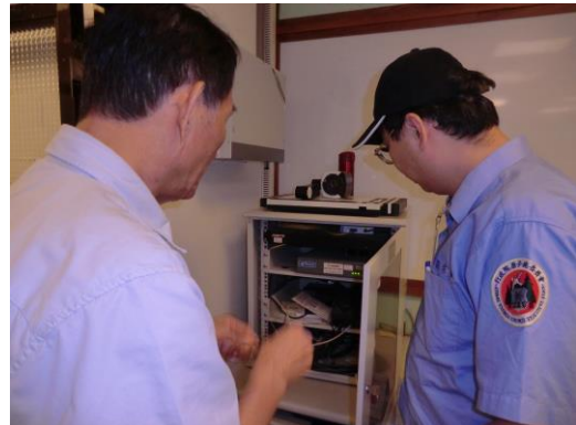
視察該廠緊急通訊設備
