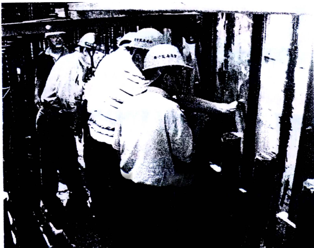
圖八：視察 RCCV LINER 焊道鏽蝕狀況（補）
