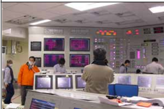
照片 5：龍門核電廠主控制室（二）
