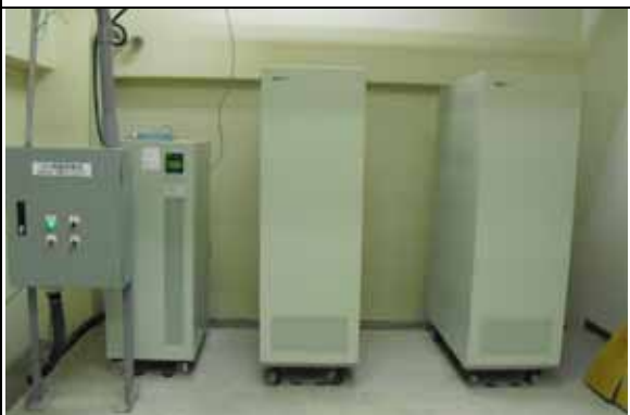
照片 6：模擬器 UPS 及隔離開關箱
