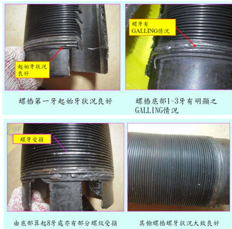
圖 10 目視檢驗確認螺樁損傷區域
