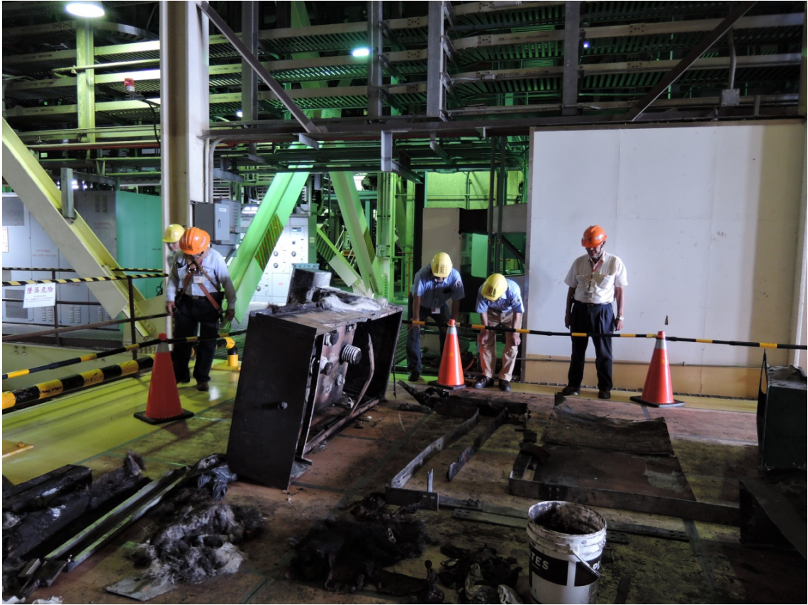
圖六.3 視察團隊檢視受損設備
