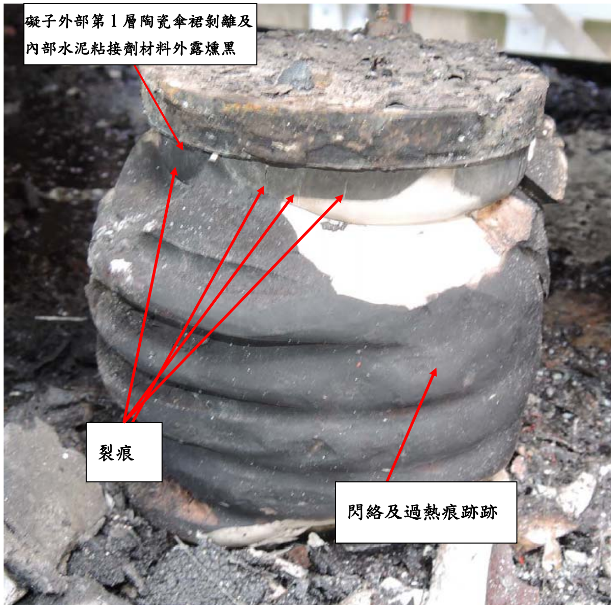
圖四.4 輔變 13.8 kV NPBD 內 A 相水平第 1 個礙子受損情形
