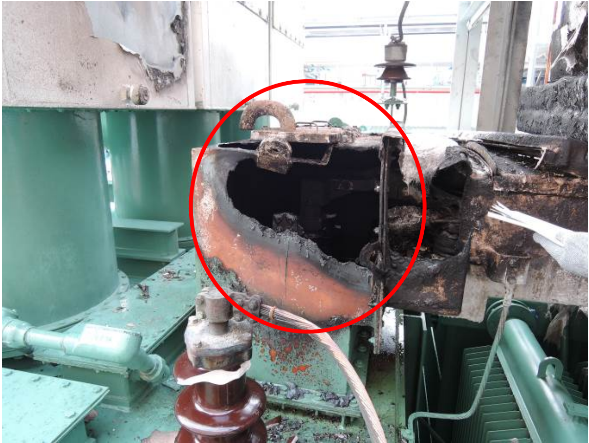
圖四.2 輔變 13.8 kV 導口箱靠近 A 相之外殼熔損
