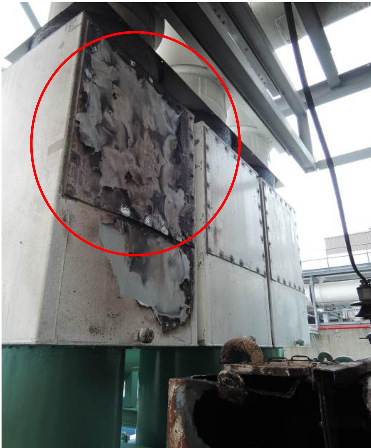
圖四.1 輔變 25 kV IPBD 外殼有煙燻痕跡
