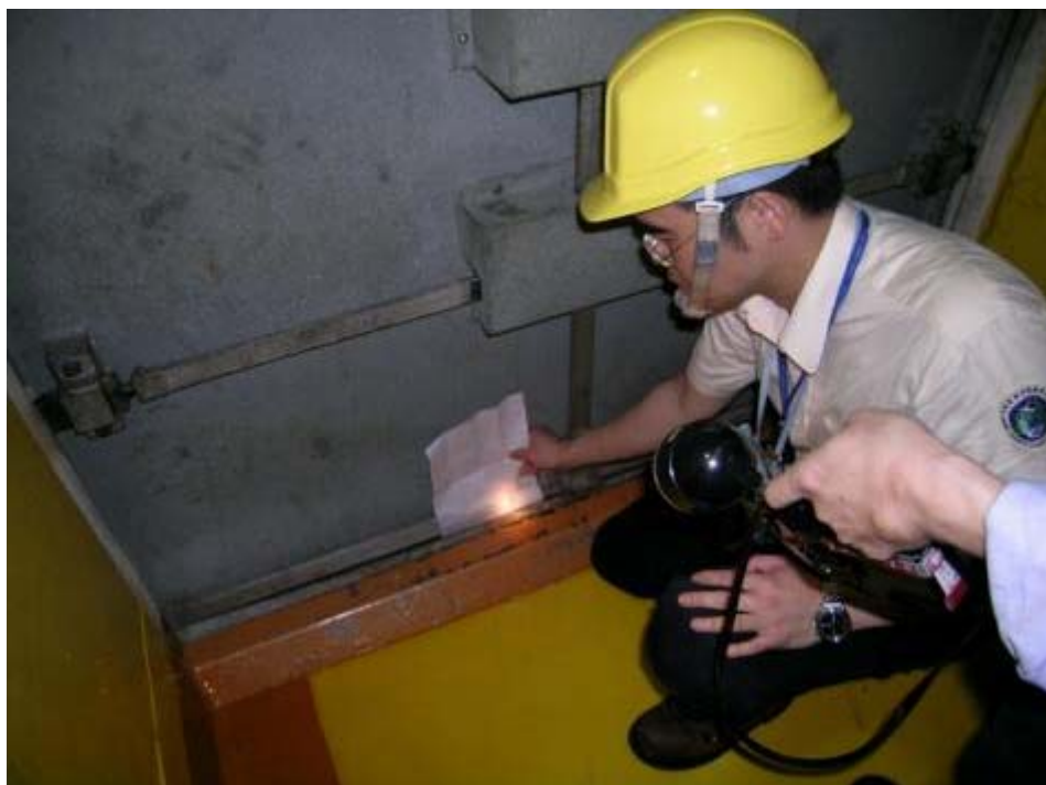
圖六：測試二號機 RHR A 泵室防水門密封性
