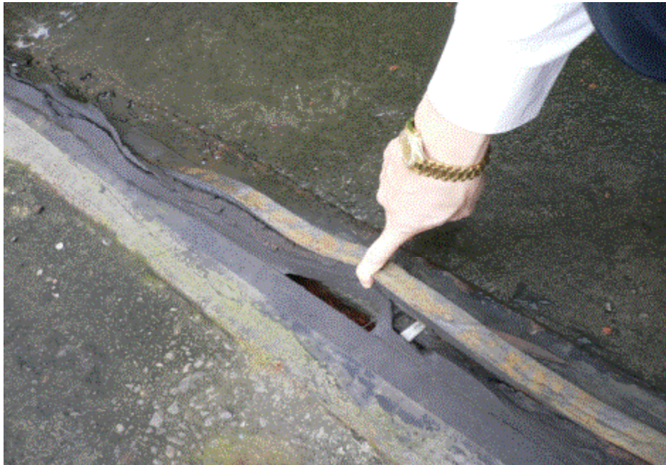
圖五：ECW 及電纜線渠道之地面人孔蓋 SEALING 有部份破損
