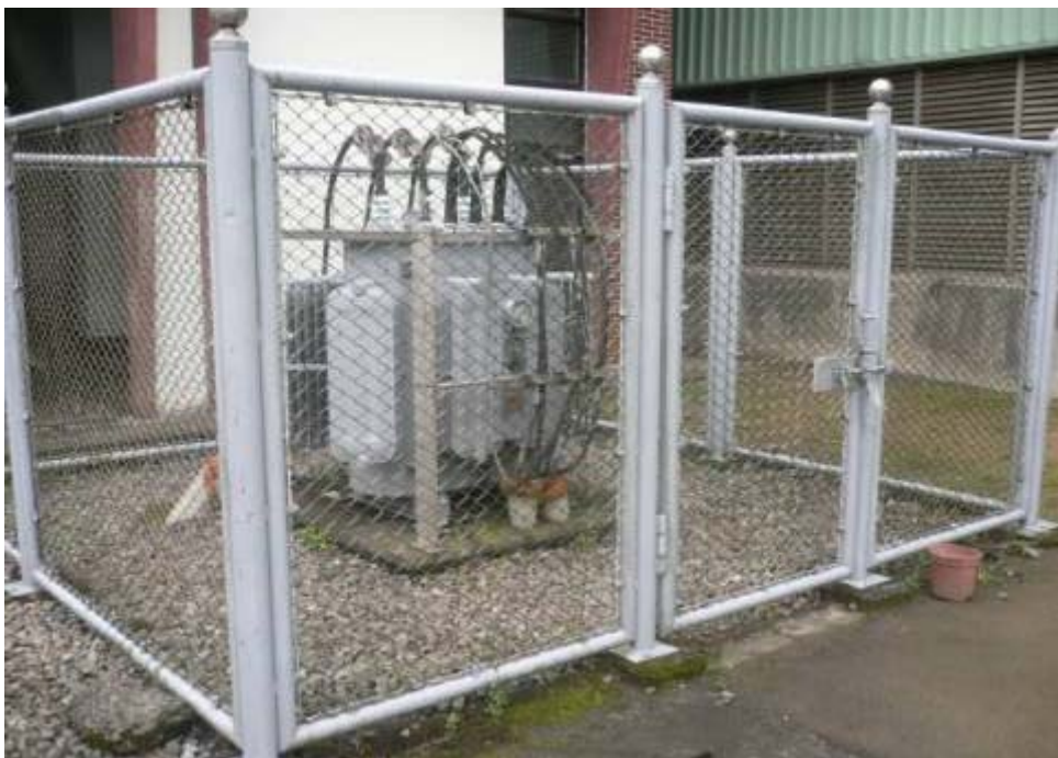
圖三：汽渦輪機旁之柴油發電機房臨近水溝旁，現場未設置堰牆或檔水設施
