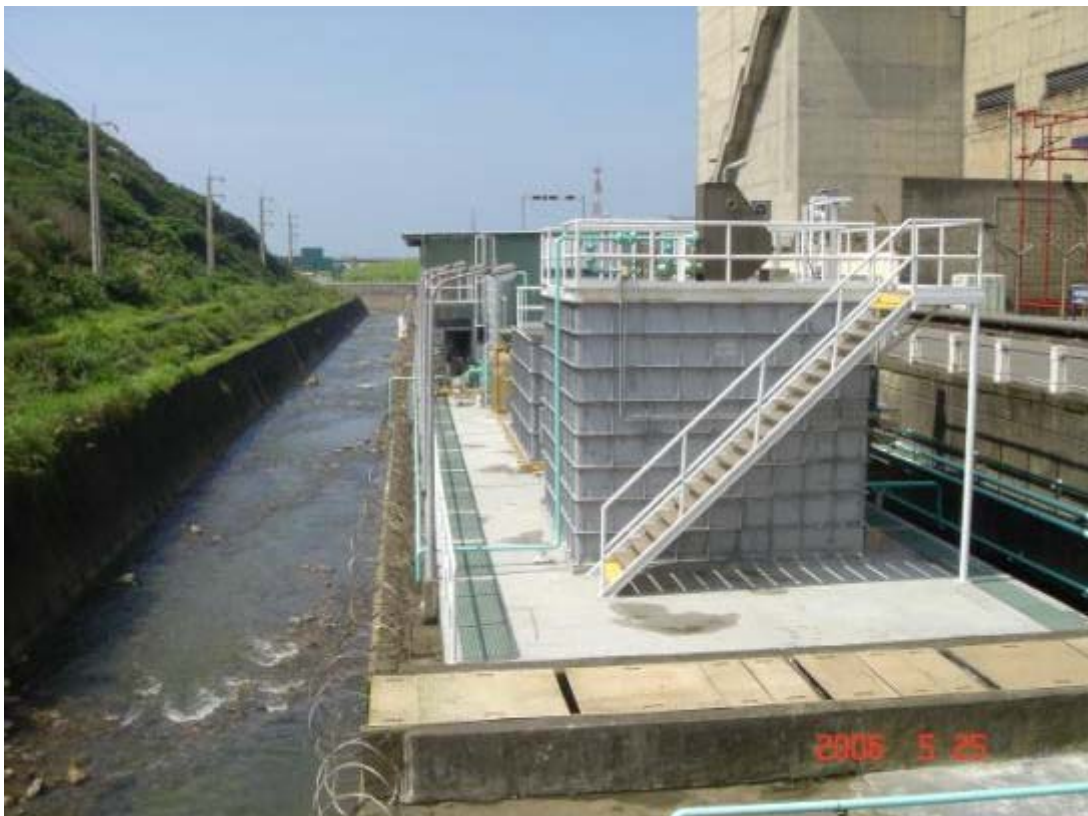
核一廠 DCR-1628 建於乾華溪護岸情形
