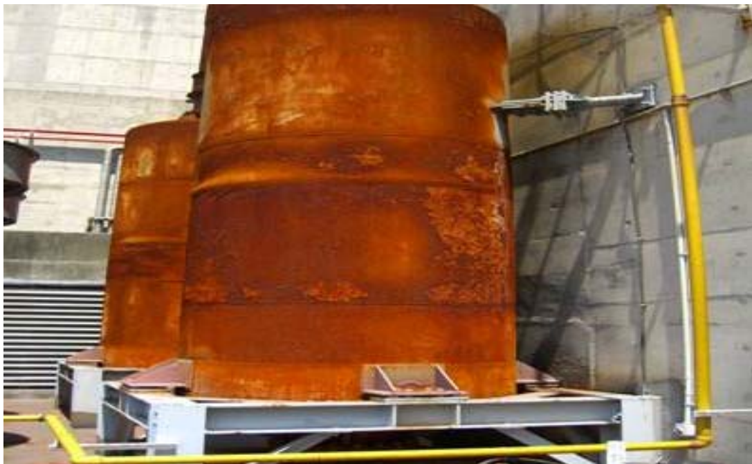
二號機緊急柴油發電機之排煙管下半部嚴重銹蝕情形
