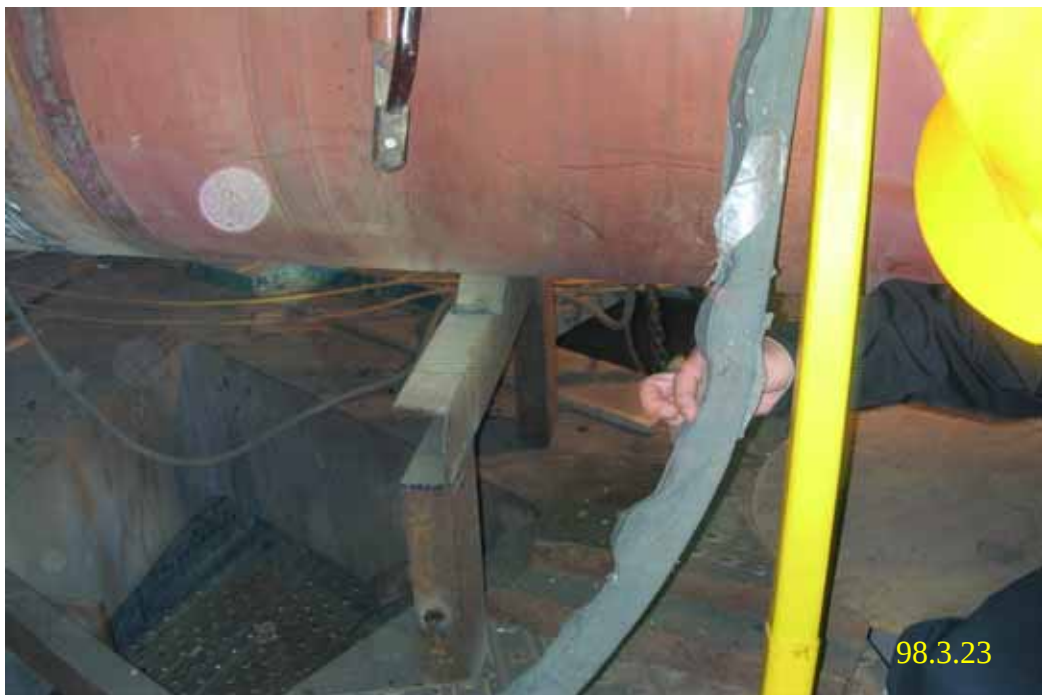
照片六：主蒸汽管路以尖角物件進行管路臨時支撐情形
