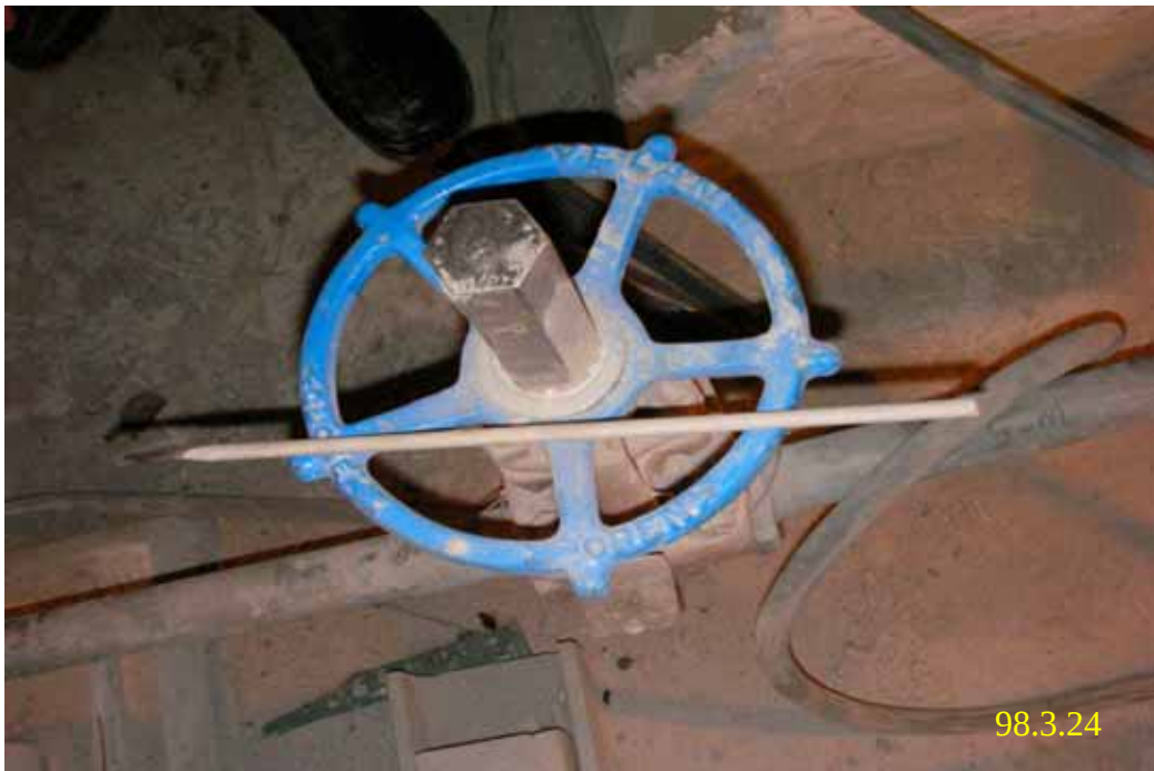
照片七：一號機 1E11-GUD-802121 支架使用不合格鐸材進行點鐸
