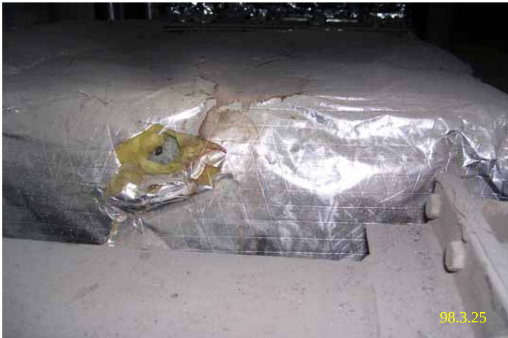
照片九：一號機反應器廠房 RHR A 房間內風管保溫棉破損情形
