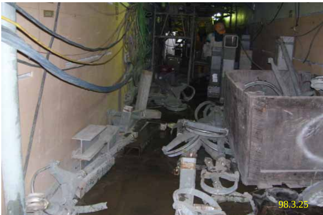
照片八：二號機反應器廠房 543 房間附近地面大片積水情形
