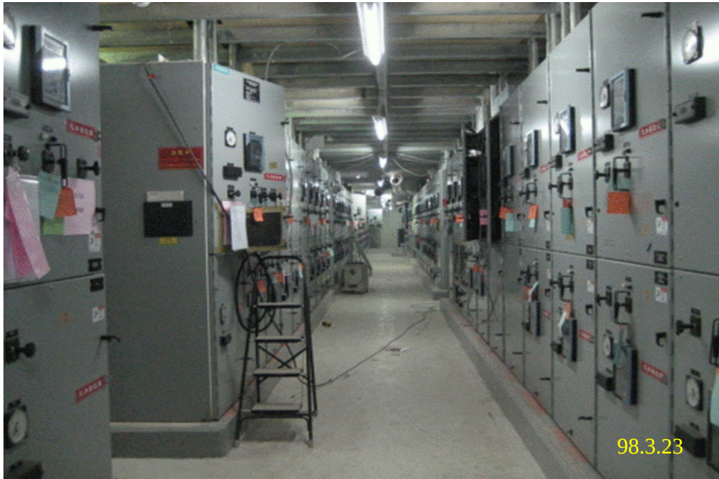
照片三：一號機開關廠房中壓開關加壓現況
