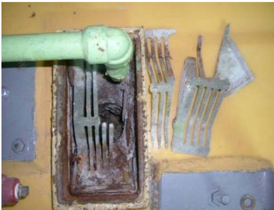
說明：一號機 B 串緊要寒水室洩水孔阻塞及攔污柵破損。
