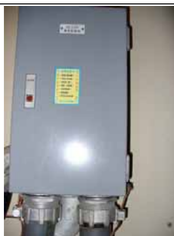
圖 14 電源箱電纜護套連接不完整
