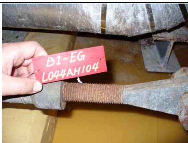
圖 13 管路支架銹蝕
