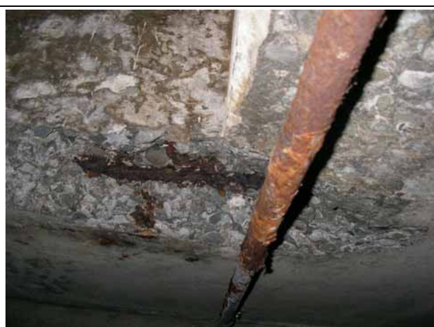
圖 2 泵吸入口結構水泥塊脫落損壞
