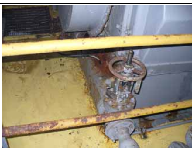
圖 6 迴轉欄污柵基座鏽蝕嚴重
