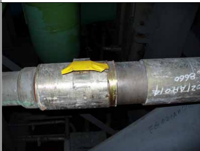
圖 11 支架避震器名牌脫落以膠布固定
