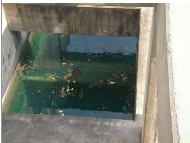
圖 3 緊急集水池內有漂浮雜物
